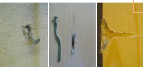
Plastická deformace a rozšíření otvorů po cyklicko-dynamickém zatížení konstrukce. Sádrovláknité desky FERMACELL (vlevo), spojovací prostředky (uprostřed), spodní dřevěná konstrukce (vpravo)
